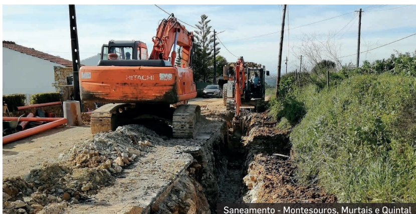
Saneamento - Montesouros, Murtais e Quintal
